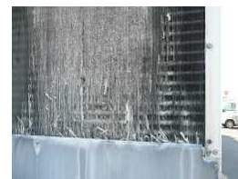
室外機の腐食
