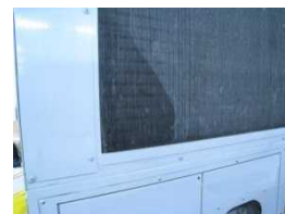
室外機の油にじみ
