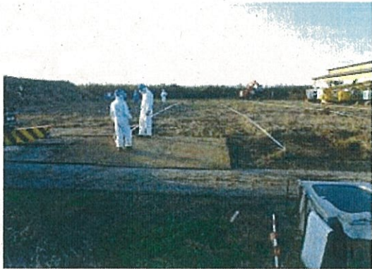
焼却ヤードの整備 (進入路に鋼板を敷き、 不陸整正(平坦にすること)を行う)
